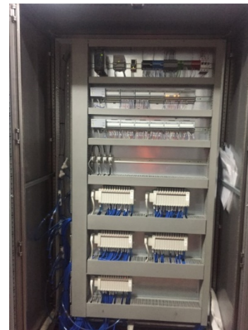
Figura 17: Gabinete de control nuevo
