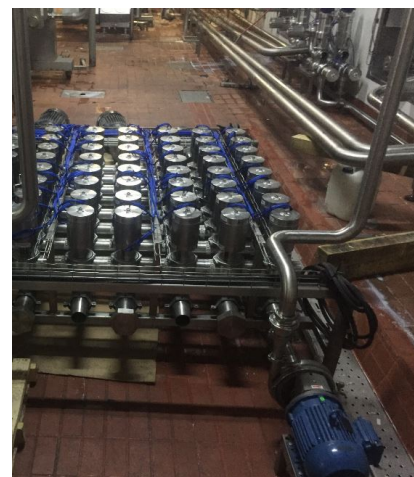
Figura 18: Clúster nuevo instalado
