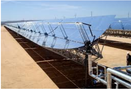
Figura 1. Configuración del colector solar parabólico
