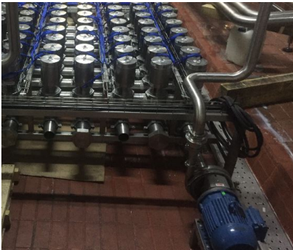
Figura 6: Clúster nuevo instalado
